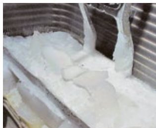
Eisbildung am Außengerät ohne Wannenheizung
