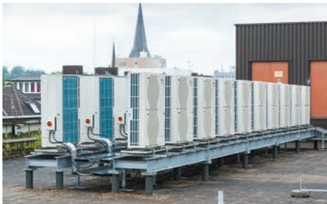
Insgesamt 20 Ecodan Luft/Wasser-Wärmepumpen – aufgeteilt in vier Kaskaden – versorgen die neuen Mietflächen mit Wärme und Kälte.
