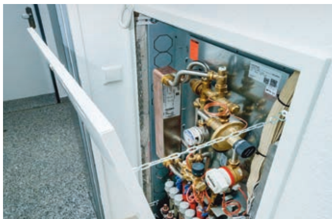
Frischwasserstationen in jeder Wohnung garantieren eine besonders hygienische Versorgung mit Trinkwasser.
