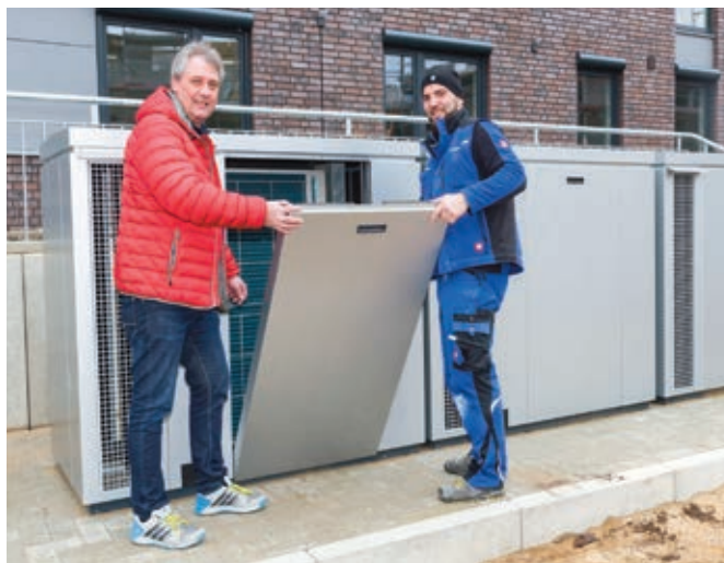
Klaus Schierenbeck, Inhaber des gleichnamigen Gebäudetechnik-Unternehmens, und sein Mitarbeiter, Meister Mirko Bahr, schließen die Inspektionstür des QS ComfortSystems.
