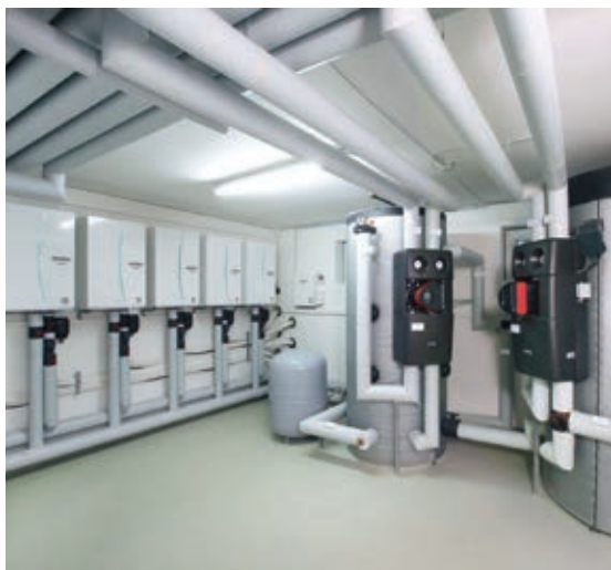
Im Heizungskeller wurden die Innenmodule der Ecodan Wärmepumpen sowie die Pufferspeicher für Heizung und Frischwasser installiert.
