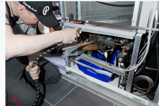
Service an Wärmepumpen
